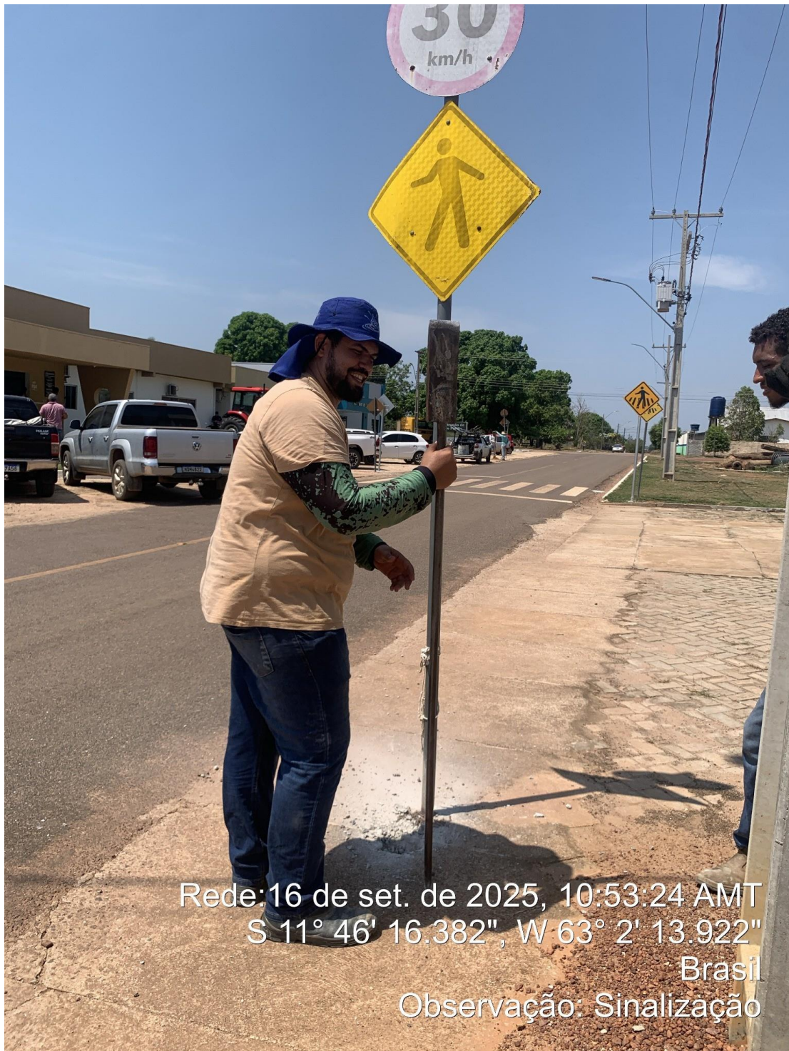
Sinalização vertical implantada – Município de Seringueiras/RO
