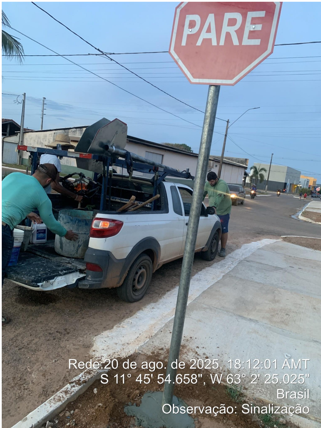
Sinalização vertical implantada – Município de Seringueiras/RO
