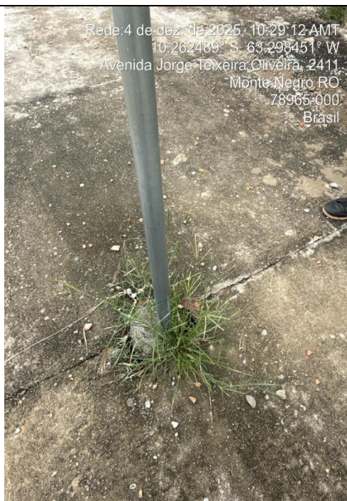
Foto 14: a sinalização vertical permanece com o suporte mal fixado.
