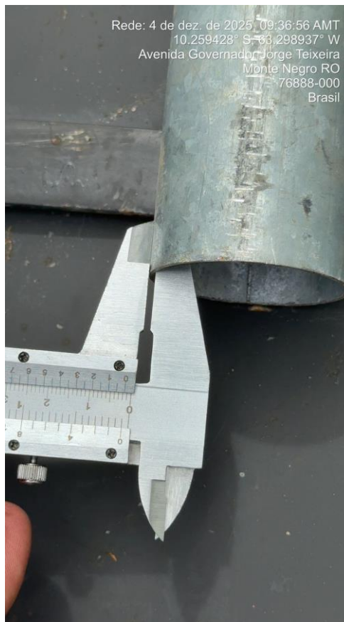
Foto 2: Chapa do suporte com espessura inferior ao especificado.
