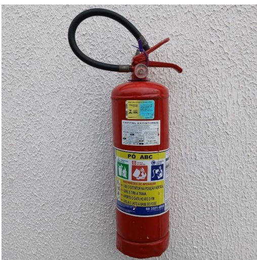
Foto 021 – Extintor de incêndio portátil com carga de pqs.
