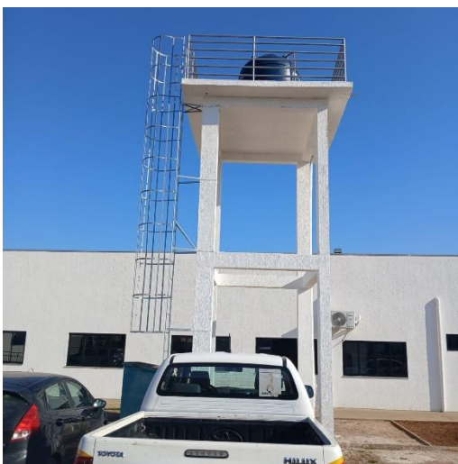
Foto 019 – Guarda-corpo de aço galvanizado e Escada tipo marinheiro, completa, com proteção, fixação, degraus e tubo de aço galvanizado 1.1/2" - CAIXA D'ÁGUA.
