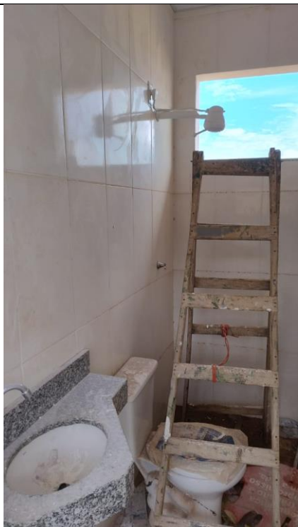
Foto 007 – Chuveiro Elétrico - GUARITA.
