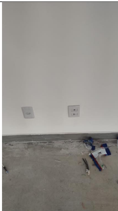
Foto 008 – Tomada 2P+T e Tomada RJ45.
