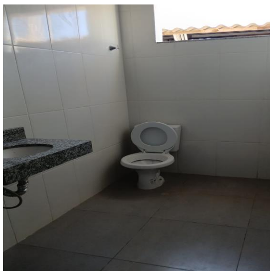
Foto 003 - Vaso sanitário sifonado com caixa acoplada louça branca - padrão médio, incluso engate flexível em metal INTERNO-SEDE.
