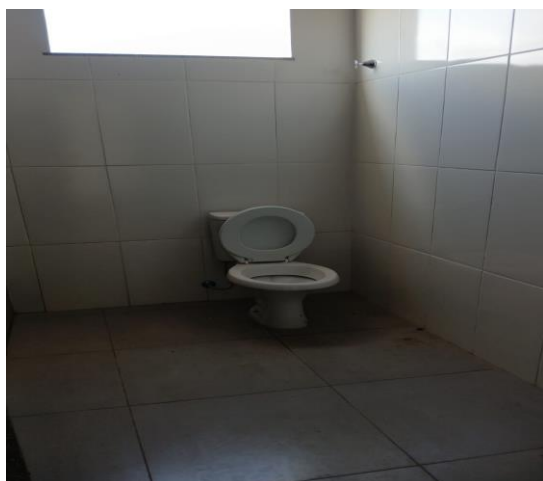
Foto 001 - Vaso sanitário sifonado com caixa acoplada louça branca - padrão médio, incluso engate flexível em metal INTERNO-SEDE.
