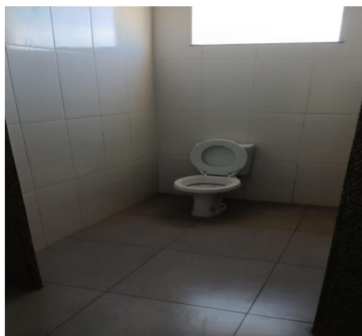
Foto 002 - Vaso sanitário sifonado com caixa acoplada louça branca - padrão médio, incluso engate flexível em metal INTERNO-SEDE.
