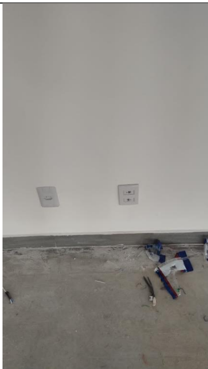
Foto 007 – Tomada 2P+T e Tomada RJ45.
