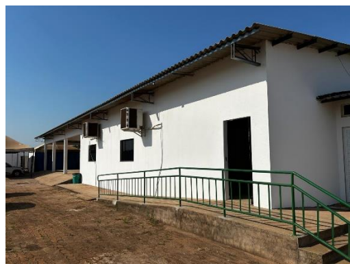
Foto 020 – Guarda-corpo de aço galvanizado de 1,10m de altura, montantes tubulares com fixador e com chumbador mecânico - GALPÃO.
