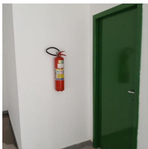
Foto 022 – Extintor de incêndio portátil com carga de pqs.
