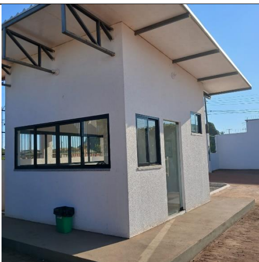
Foto 017 – Porta de abrir com mola hidráulica, em vidro temperado, 90x210 cm, espessura 10 mm - GUARITA.
