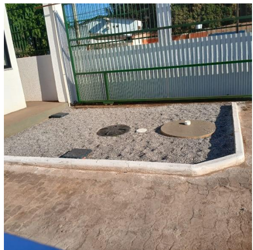
Foto 016 – Sumidouro (pré-moldado) e biodigestor - GUARITA.
