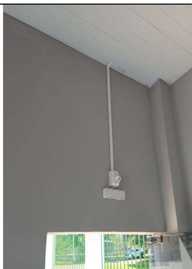
Foto 012 – Luminária de emergência.
