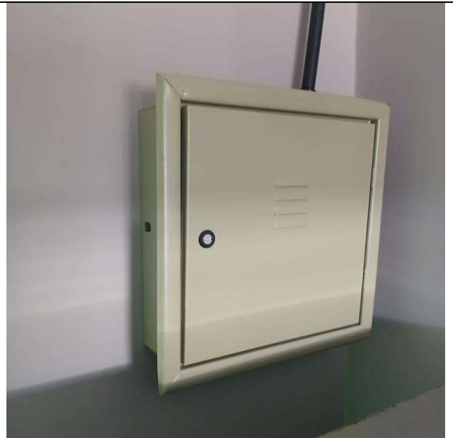
Foto 012 – Quadro de distribuição para telefone n.3, 40x40x12cm em chapa metálica, de embutir, sem acessórios, padrão Telebrás.
